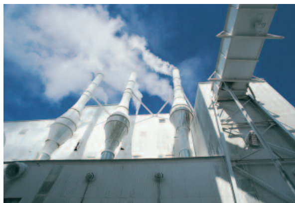
烟囱降雨分离装置有助于净化排放气体。
