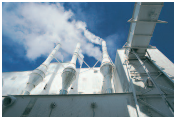
Séparateur pour cheminée servant à l'épuration des émissions.
